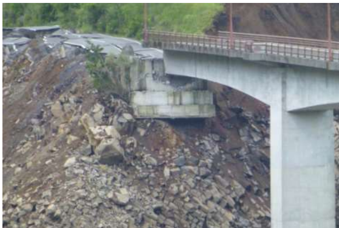
地盤変状の影響に対する橋の破壊形態 (2016年熊本地震)
