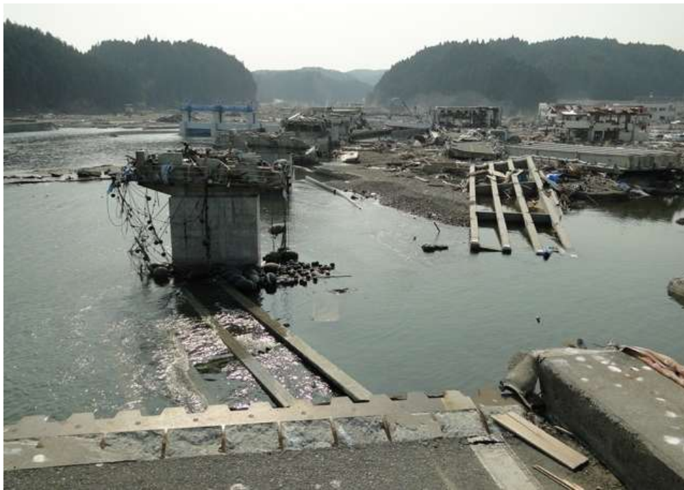
歌津大橋(2011年東北地方太平洋沖地震で発生した津波の影響による上部構造の流出)
